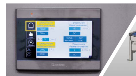
Сенсорный экран силового шкафа
