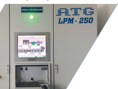
Система управления на базе контроллера типа Siemens
